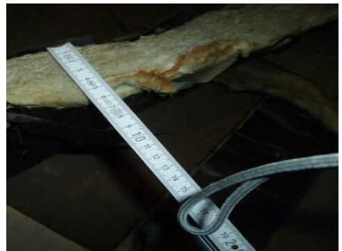
Dämmung oberste Geschossdecke über Aula
