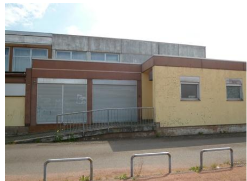
Großflächige, veraltete Fenster Anbau
