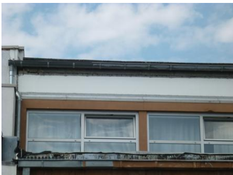
Großflächige, veraltete Fenster Turnhalle
