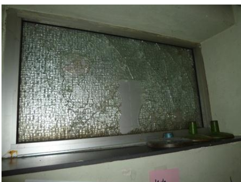
Zerstörte Fenster in Turnhalle
