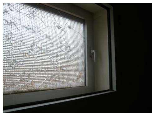
Zerstörte Fenster in Bühnenanbau
