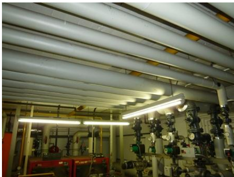
Die Verteilleitungen sind gut gedämmt.
