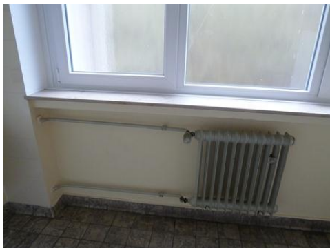
Heizkörpernische, hier in WC Bereichen (Wärmebrücken)
