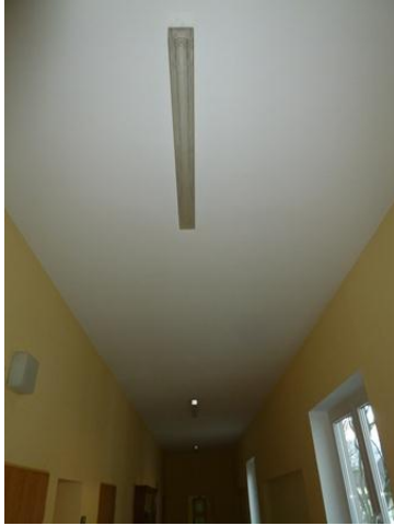
Beleuchtung in Fluren
