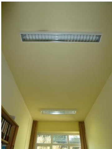
Beleuchtung in Büros
