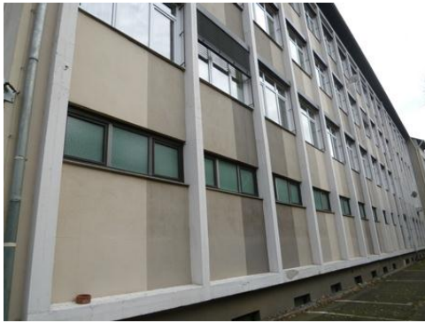
Ausmauerungen zwischen Stahlbetonskeletten (Wärmebrücken)
